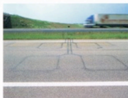
Detectielussen worden op regelmatige afstand aangebracht in het wegdek. Hiermee kan de snelheid en de intensiteit van passerende voertuigen worden gemeten.
